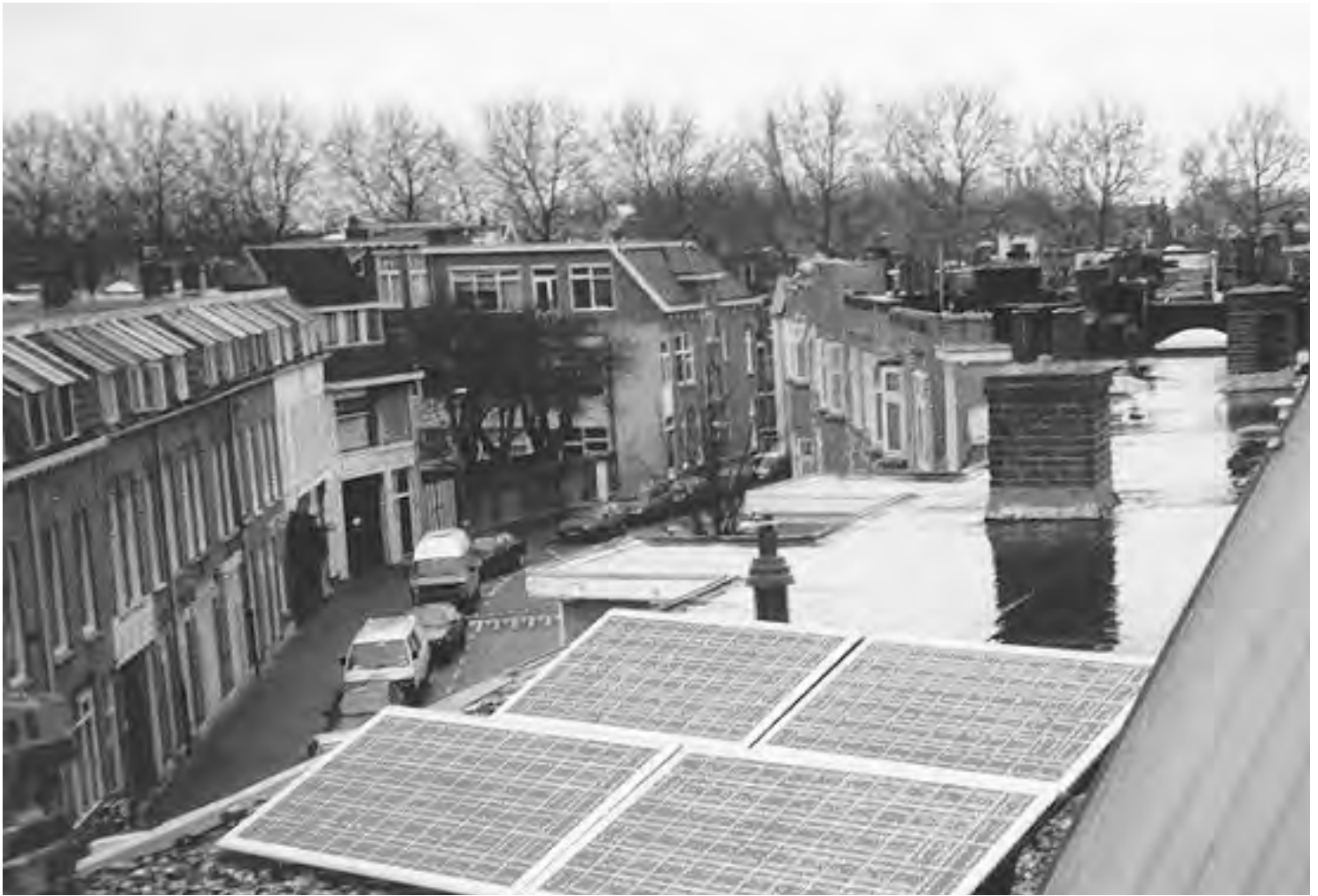
De installatie op het dak: links de vier AC-modules, rechts de zonnecollector. De AC-modules zijn gemonteerd op een plastic bak die verzwaid is met 4 stoeptegels, 32 kg. Dit maakt het systeem stormbestendig. Middenvoor de dakdoorvoer, waar de electriciteitskabels van de zonnepanelen en de geïsoleerde waterleidingen van de zonnecollector doorheen gaan (foto auteur)
