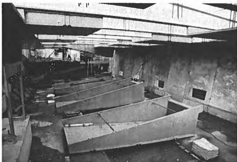
foto 3807 - de waterbakken op de vloer van de centrale hal
